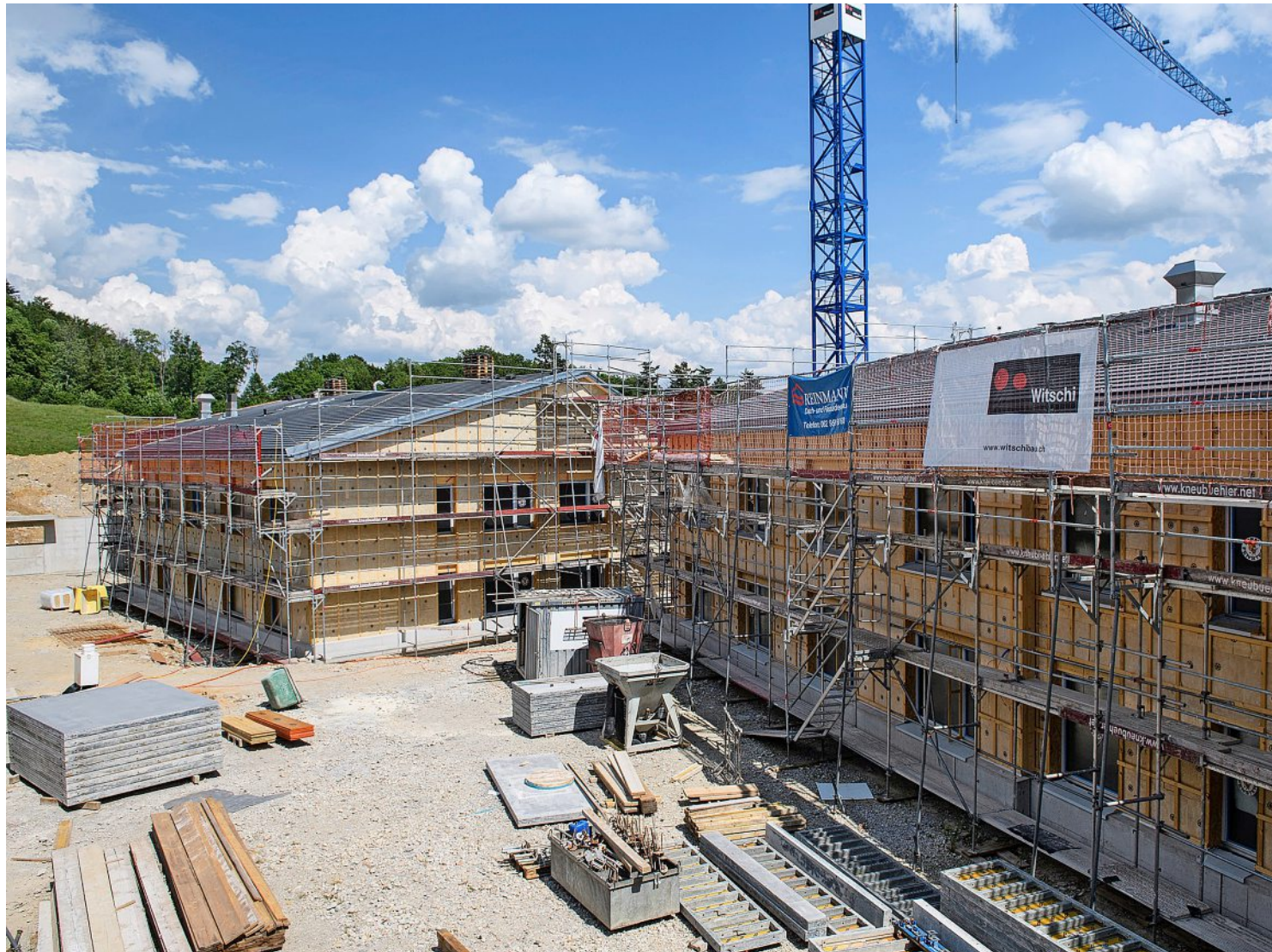
In den zwei neuen Gebäuden, die in der ersten Etappe entstehen, haben die Innenbauarbeiten begonnen. Fotos: Raphael Moser
